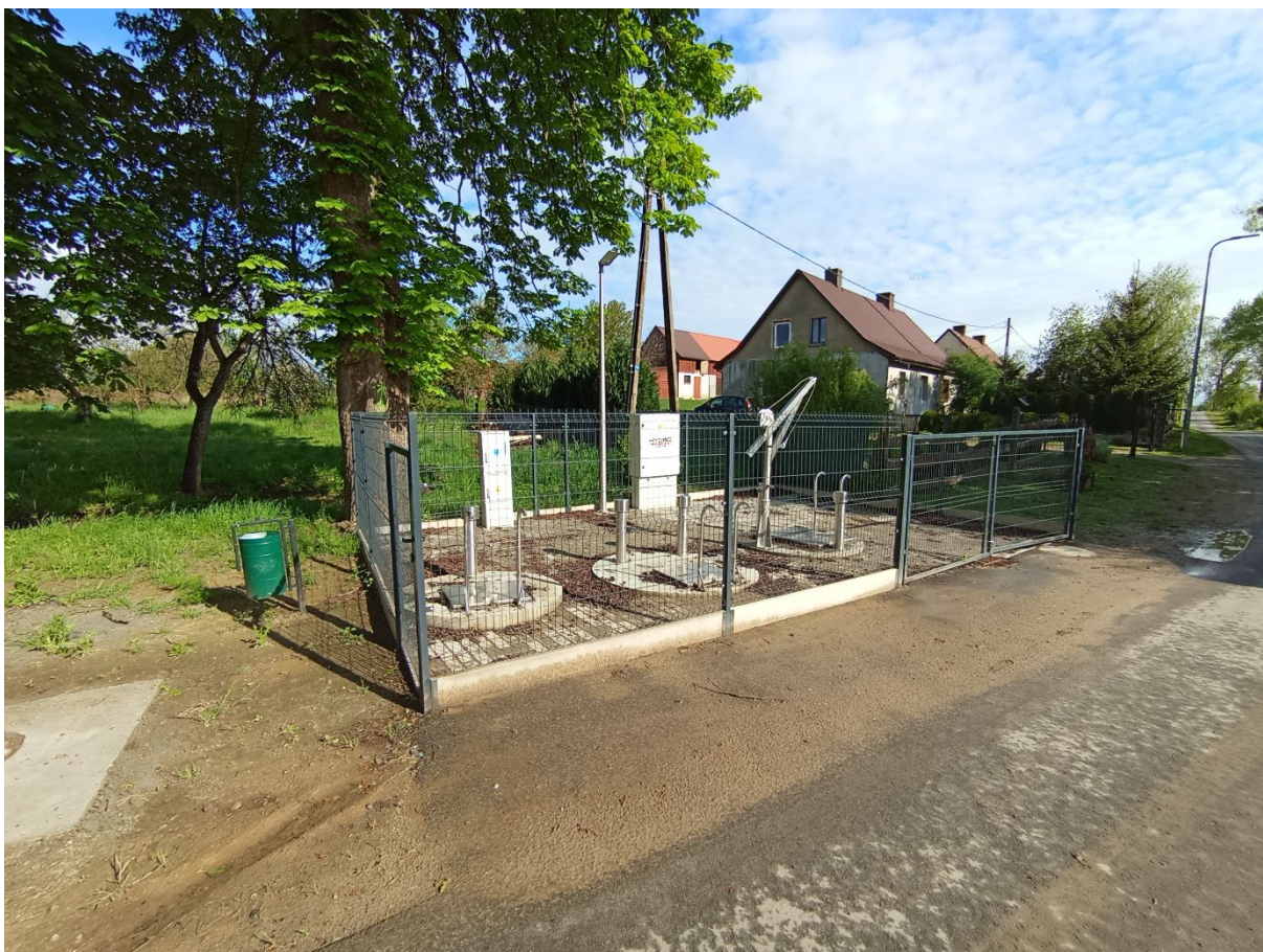
Nowoczesna przepompownia ścieków w miejscowości Konotop
